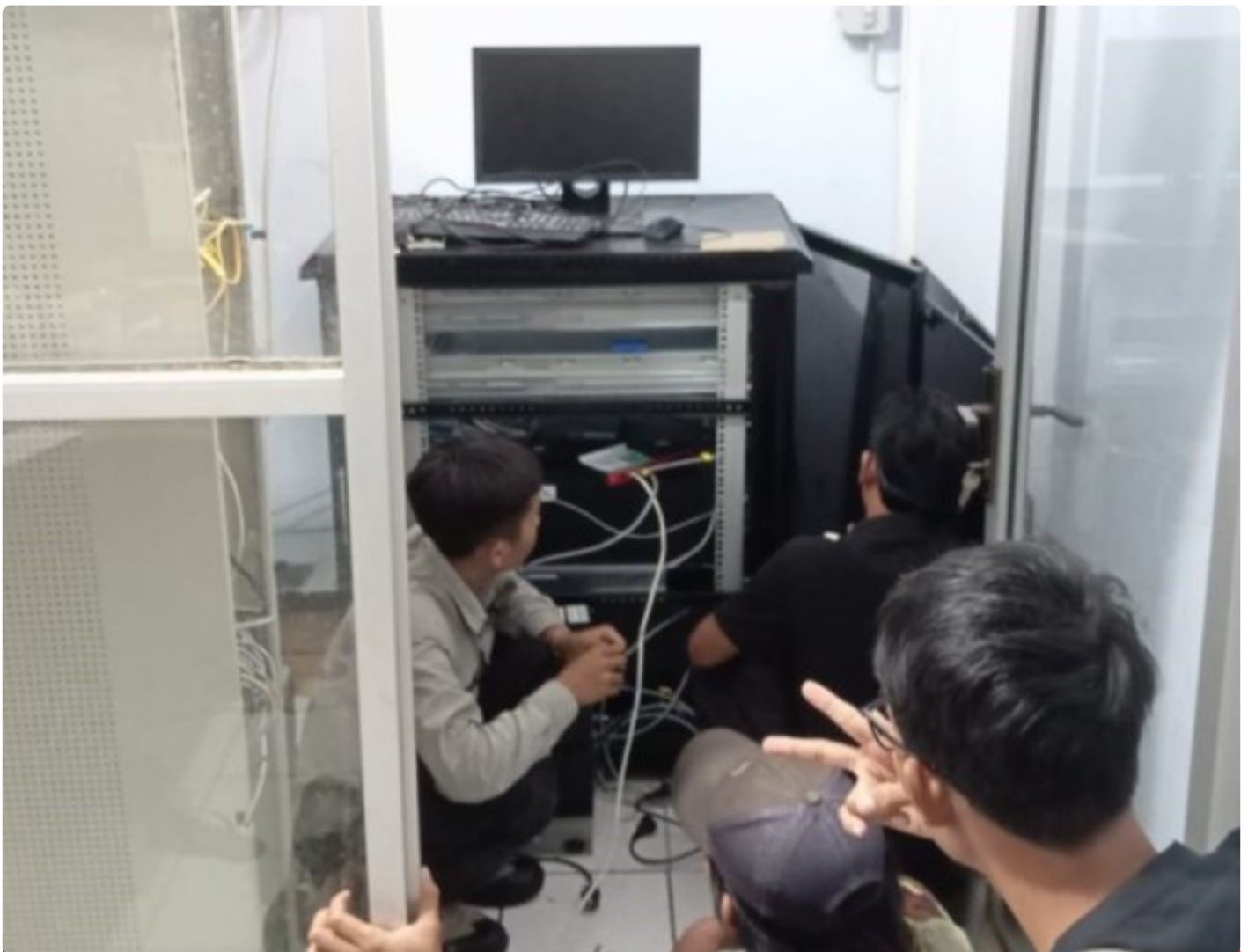
Tingkatkan Pengamanan, Lapas Besi Lakukan Perawatan Server CCTV
